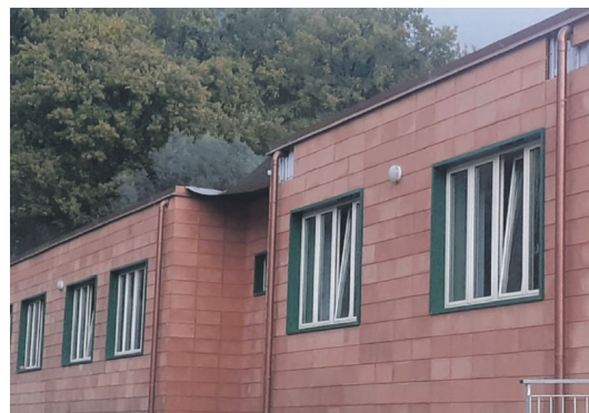
I teli che sono stati collocati sul tetto della scuola di via Magliano: il plesso si allaga quando piove
